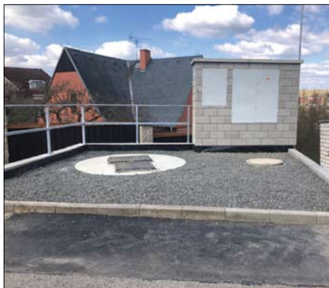
Nedávno opravená čerpací stanice odpadních vod (ČSOV) ve Slovanské ulici (foto: Květa Englerová)
