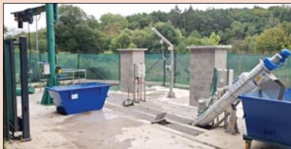
Čerpací stanice odpadních vod (ČSOV) Černý Vůl
