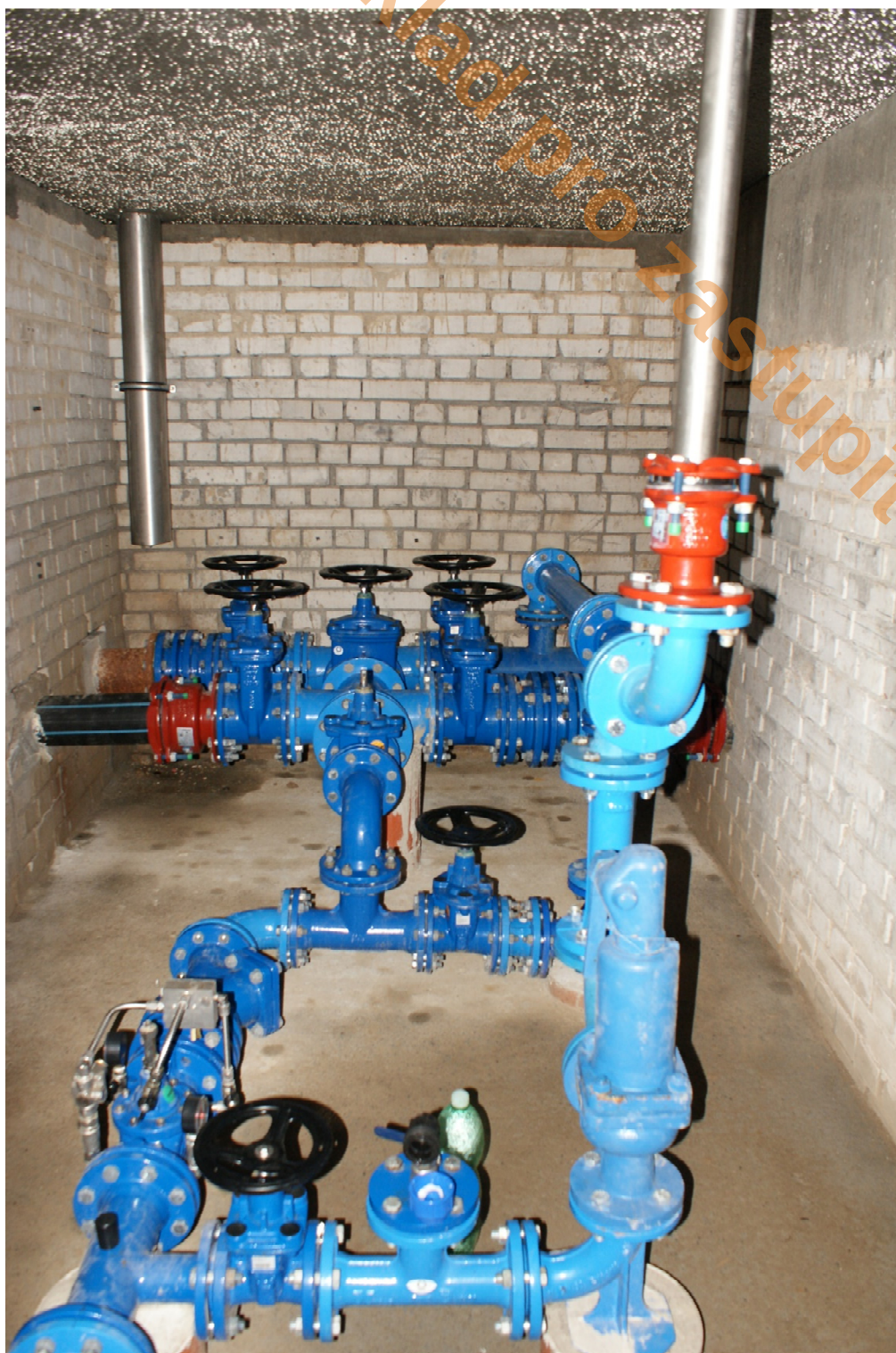
Obrázek 6: Armaturní šachta VŠ, vlevo redukční ventil, vpravo pojišťovací ventil s vývodem nad terén, vzadu přivaděč do VDJ Velké Přílepy a zásobní potrubí do AŠ2
