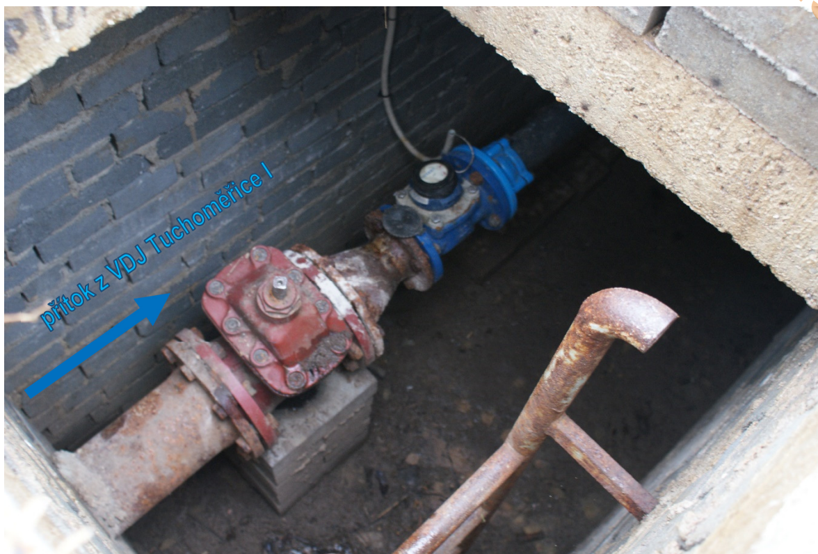
Obrázek 2: Armaturní šachta PŠ Statenice, pohled po směru toku – vodoměr
