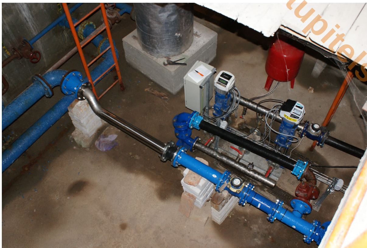
Obrázek 8: Přítokové potrubí v armaturní komoře VDJ Tuchoměřice I
